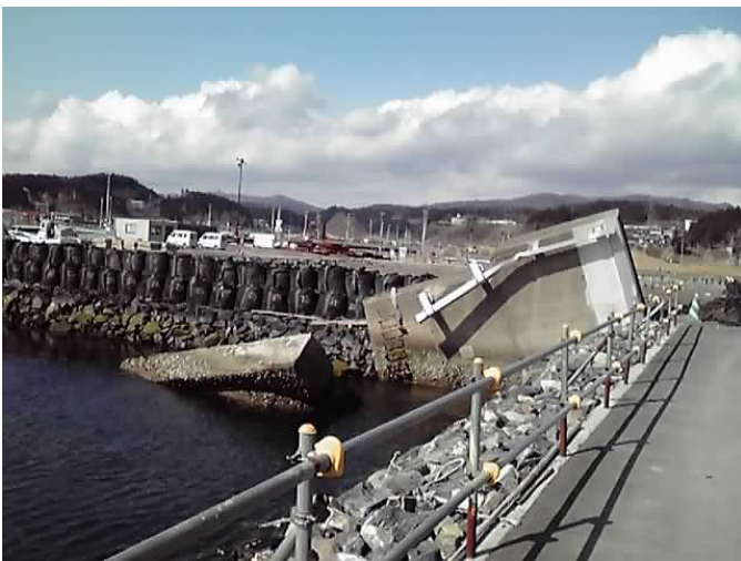
津波により破壊された防波堤
